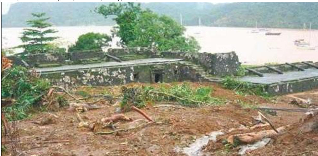
Figura 1. Fuerte de Santiago afectado por los deslizamientos, Portobelo Fuente: Periódico El Panamá América, publicada el 23 sept. 2011
